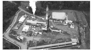
Sorik Marapi 地热发电公司(PT SMGP) Sorik Marapi 地热发电厂(PLTP) 5号机组已完成发电能力测试(URC)。
